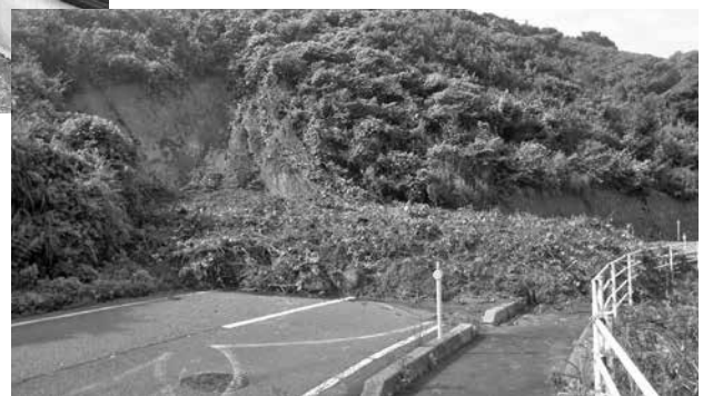
豪雨災害現場（町道乙茂久田線）
