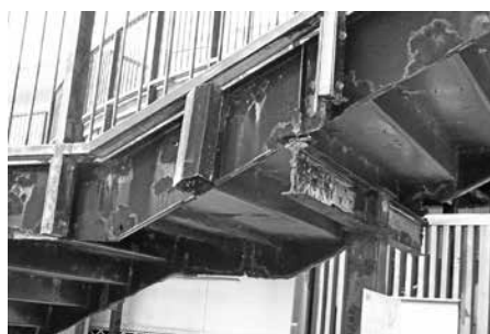
腐食したオープンデッキ
